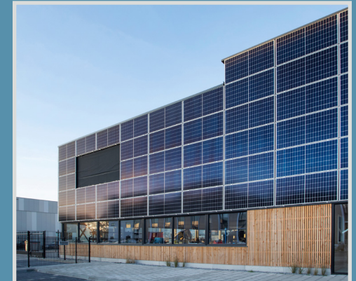
Zonnepanelen aan gevel
