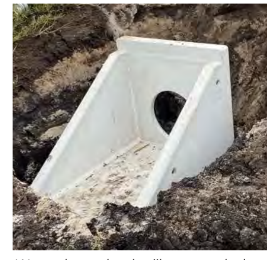
Water dat onder de rijbaan wordt doorgevoerd naar oppervlaktewater afvoeren via uitstroombak
